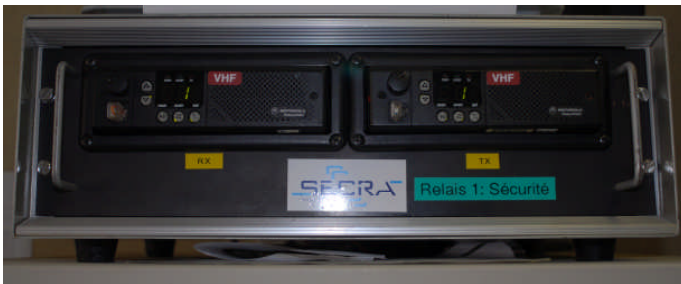
Station relais avec batterie de secours
